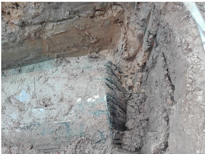
Forurening ved nedgravet olietank konstateret ved en ejendomshandel
